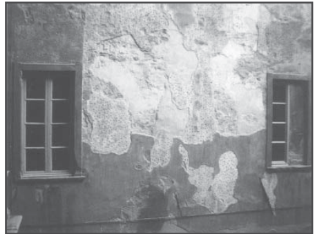
Conservatorio Donizetti, Bergamo. Particolare dei differenti strati di intonaco a base di calce conservati durante il restauro.
