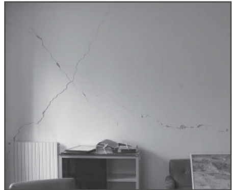
Esempio di lesione a croce in una muratura.
