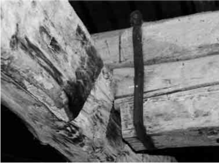
24. Sconnessione della giunzione fra catena della capriata principale e catena trasversale con conseguente deformazione del presidio metallico.
