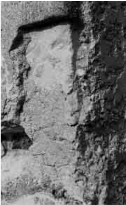
17. Distacco dell'intonaco di rivestimento delle superfici esterne.
