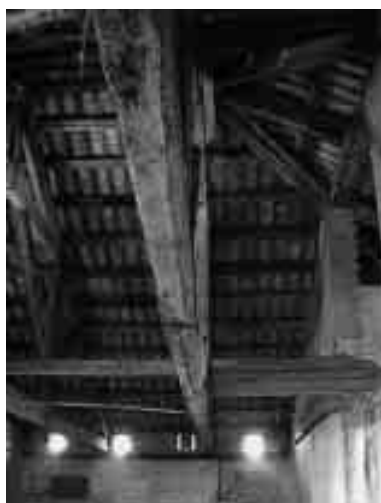
10. Le due capriate principali disposte parallelamente sono collegate da una capriata disposta ortogonalmente la cui catena composta è visibile nella foto.
