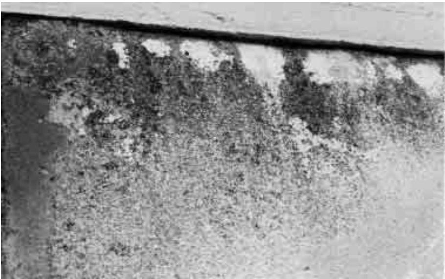
21. Patina biologica sull'intonaco a marmorino esterno.
