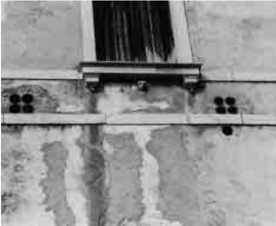
5. Porzione muraria del prospetto est. Parte dell'intonaco è stato risarcito con malta di cemento.
