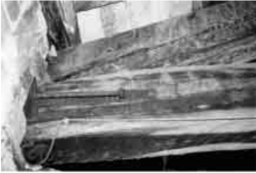
26. Particolare dell'appoggio della catena trasversale e del puntone. Gli elementi lignei della parte inserita nella muratura hanno subito un forte degrado biologico. Il puntone ha subito una rotazione rispetto alla catena.
