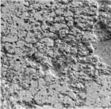
16. Disgregazione del marmorino di rivestimento delle superfici esterne.
