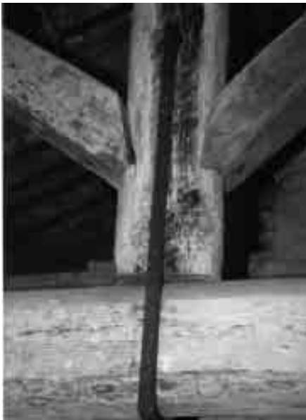
25. Cedimento del monaco sulla catena con conseguente apertura della connessione fra saetta e monaco.
