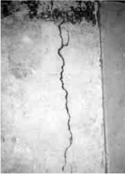
19. Fessurazione profonda visibile nel vano scale a ovest.
