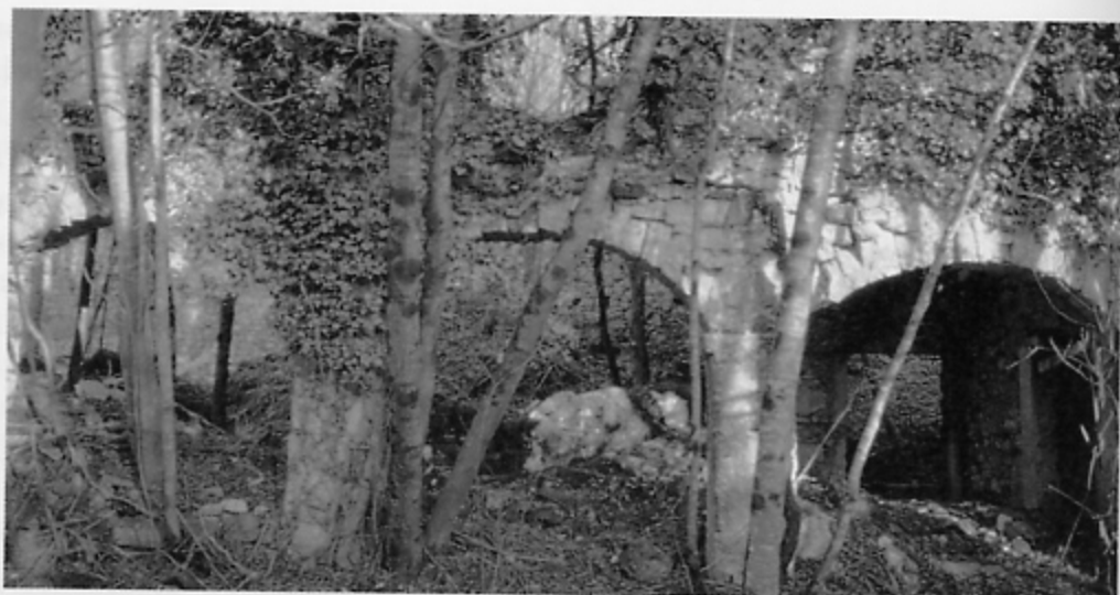
Dettaglio del portico e di quel che resta delle murature del primo piano. La residenza di Domenico Masutti era dotata anche di un sottotetto usato come deposito o granaio
