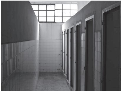
Figura 55. Batteria di docce alla Dardi.
