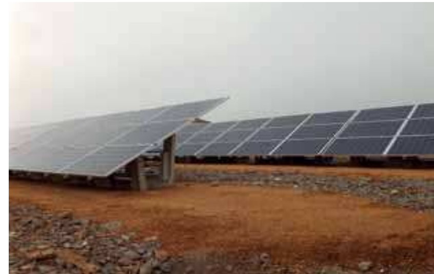
I pannelli fotovoltaici costruiti sopra le macerie della caserma di Vacile hanno cancellato i segni fisici dell'insediamento militare, ma hanno permesso di non consumare suolo nella costruzione del più grande impianto fotovoltaico del Friuli Occidentale.
